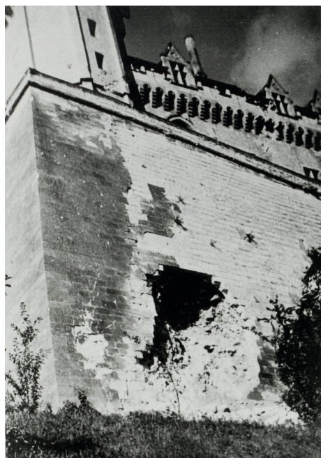
Impacts sur les murailles basses du château de Saumur © Archives municipales de Saumur
