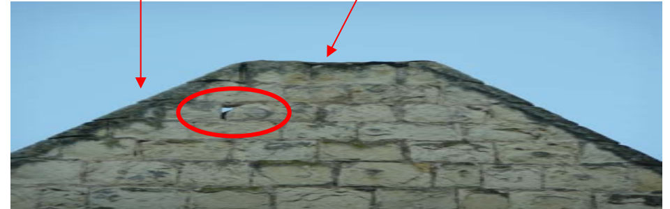
Reprise à la chaux des rondelis et mise en place d'une étanchéité en plomb sur partie plane de pignon
